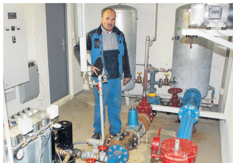
Wassermeister Werner von Olnhäusen zeigt die alte Installation der Druckerhöhungsanlage an der Beethovenstraße in Massenbachhausen. Foto: Claus Rehder
